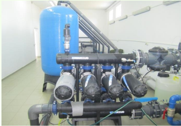
Оборудование водозаборного узла
